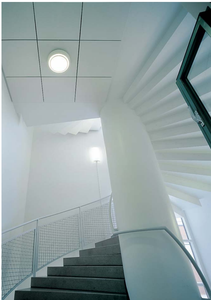
Trapperom er et eksempel på flater hvor en direkte limt himlingplate kan gjøre underverker for både lyd miljø og estetikk.
